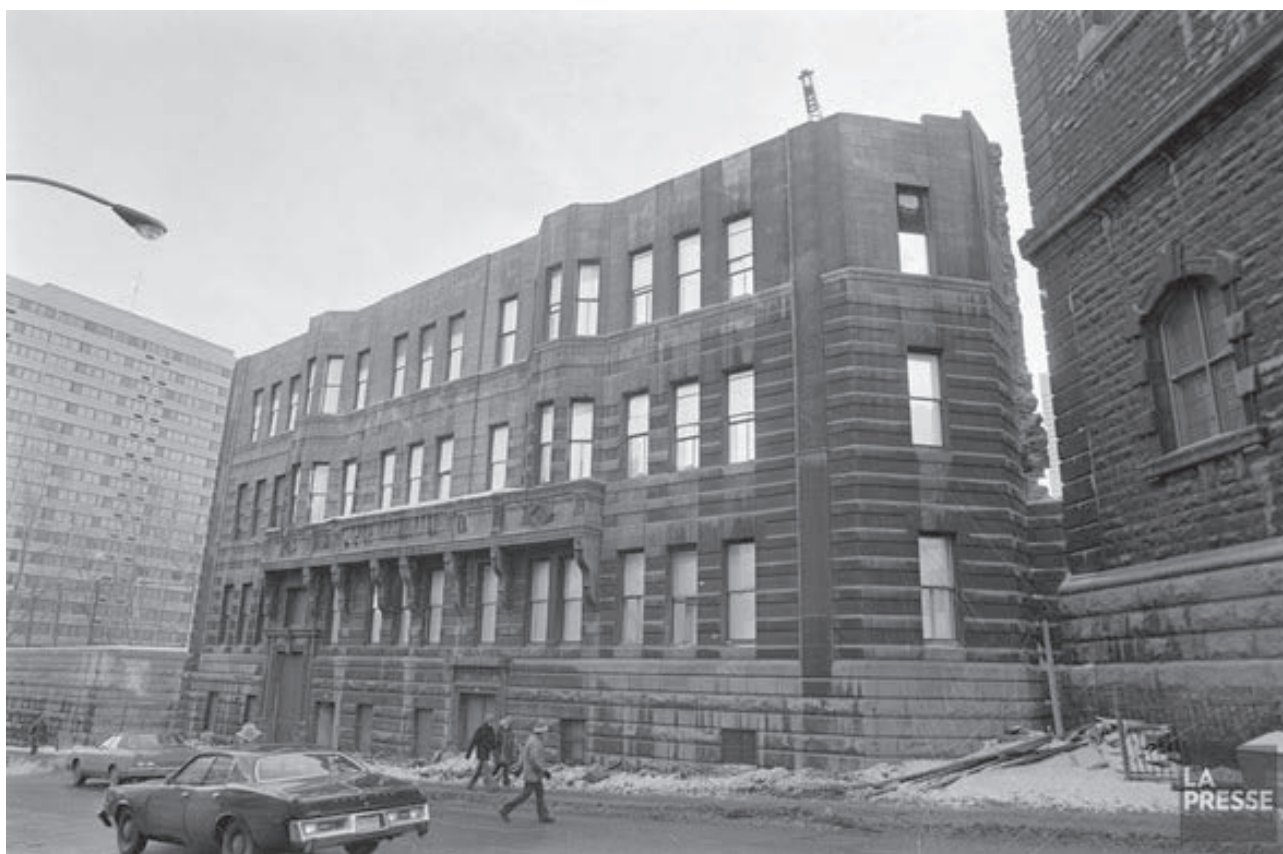
Le squelette de notre collège à l'automne 1976! D'autres photos inédites de la démolition du collège paraîtront dans le volume Le Sainte-Marie, de collège à université
